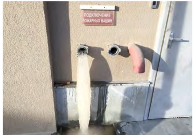
Рис. 2 - Система сухотрубов в неисправном состоянии [6]
