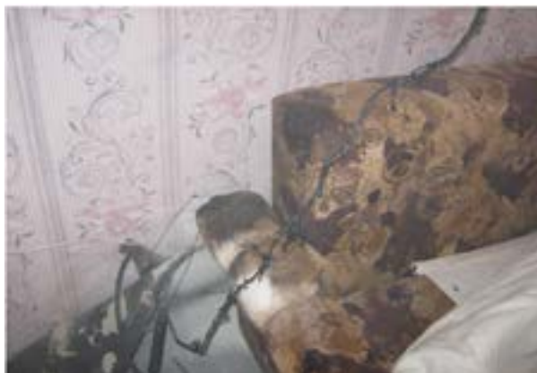
Рис. 6. Поврежденная изоляция электропровода в результате токовой перегрузки и локальные участки тления на спинке дивана от упавших горящих капель изоляции электропровода
