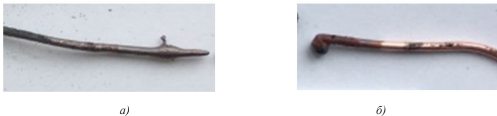
Рис. 2. Локальные оплавления, формируемые при перегрузках проводников, размещенных непосредственно на поверхности стены: а – конусообразное, б – шарообразное
