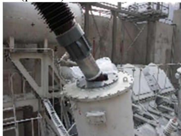
Рис. 2. Поврежденный в результате взрыва шунтирующий реактор
