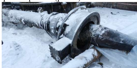
Рис. 7. Оторванная вводная втулка шунтирующего реактора РОДЦ-60000/500
