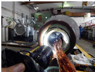
Рис. 8. Внутренняя полость демонтированного изделия «Втулка прорезиненного волокнистого трансформатора» с реактора фазы А
