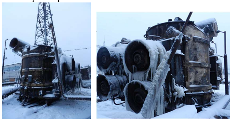
Рис. 3. Поврежденный взрывом реактор
