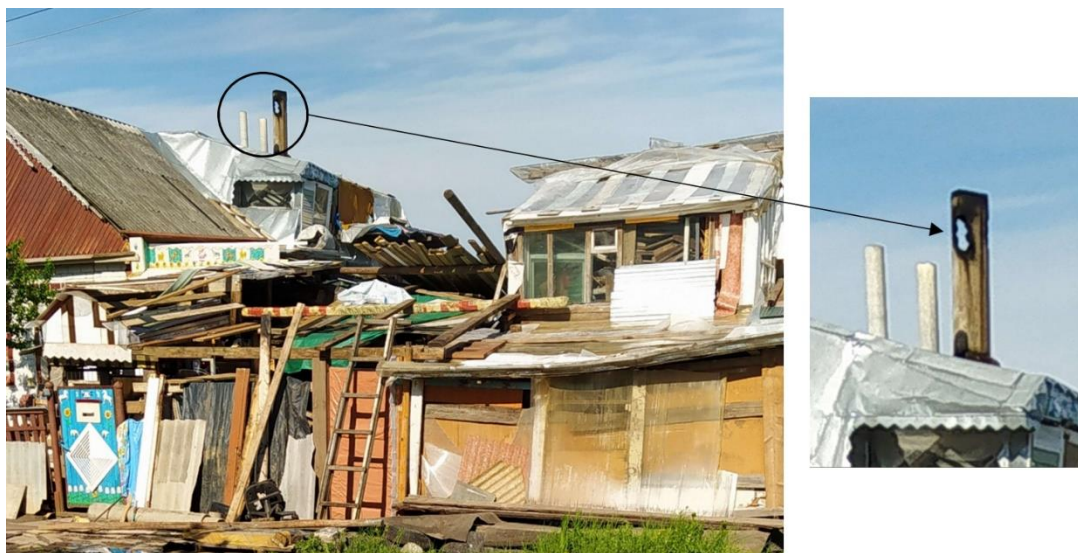
Рис. 1. Состояние дымохода нетеплоемкой печи дома (до пожара)
