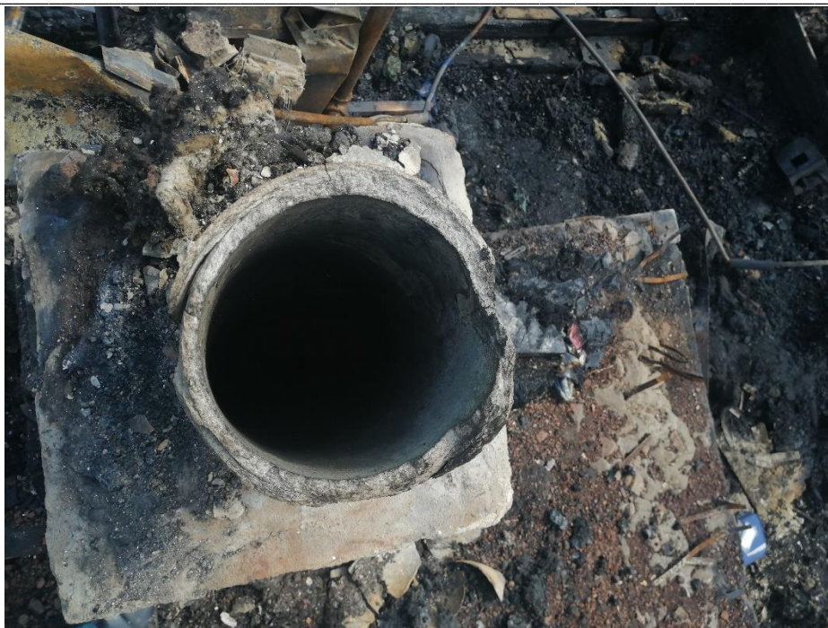
Рис. 2. Вид асбестоцементной дымоходной трубы над помещением бани сверху (после пожара)
