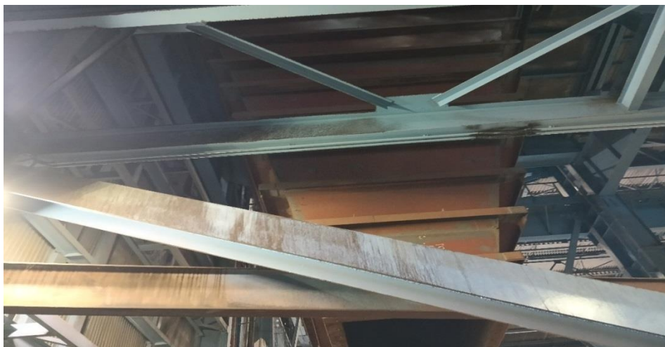
Рис.1 – Образование налета на плоскости металлических конструкций
