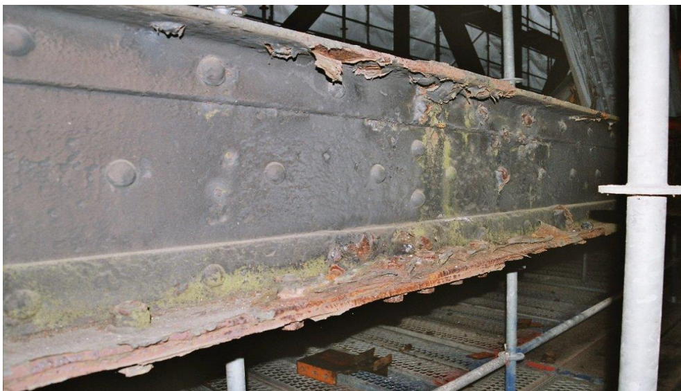
Рис.2 – Растрескивание с последующим отслоением огнезащитного покрытия от металлической конструкции
