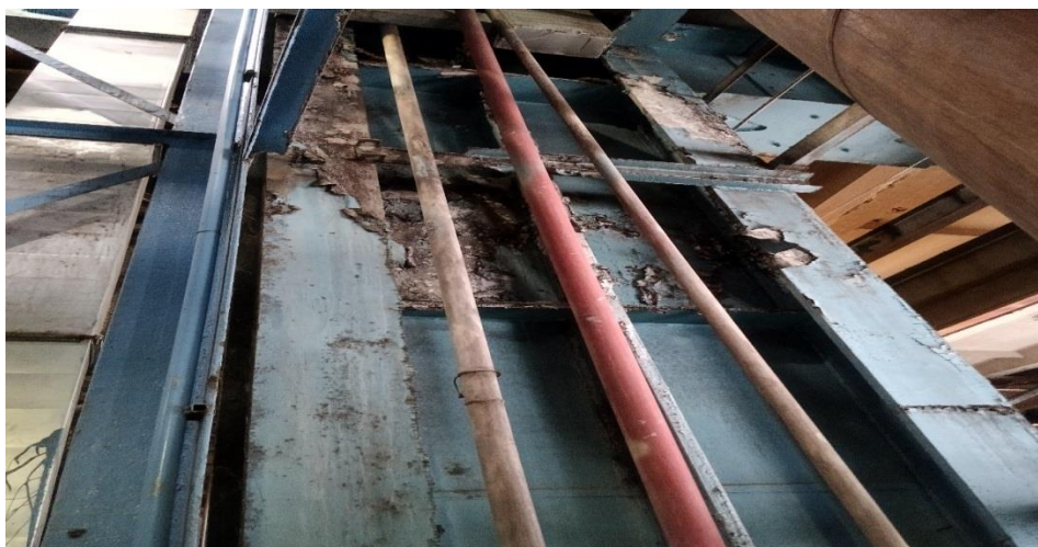
Рис.3 – Отслоение огнезащитного покрытия
